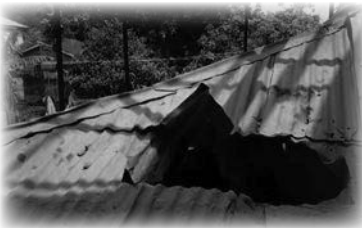
Het dak dat doorboord werd door het grote stuk rots
